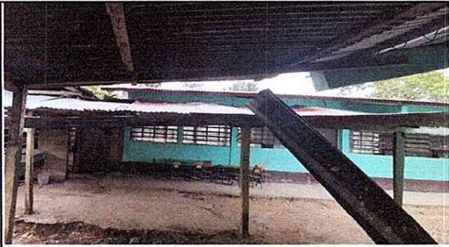
Foto 1: Deterioro de estructura y cubierta de lámina
