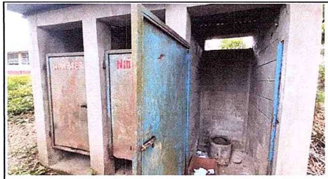
Foto 4: Deterioro de letrinas
