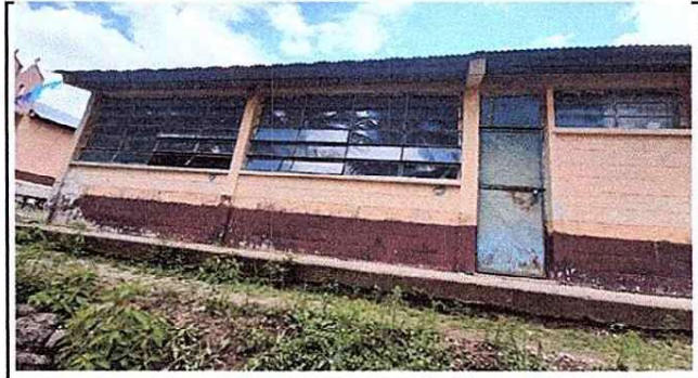
Foto 2: Deterioro de puertas
