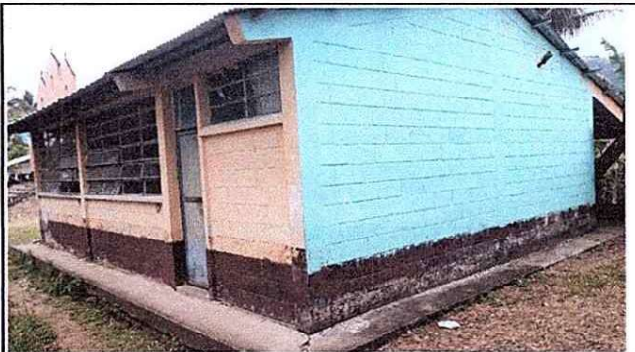
Foto 3: Deterioro de pintura
