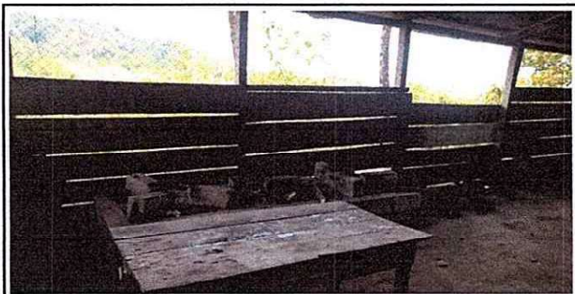
Foto 5: Deterioro de cocina
